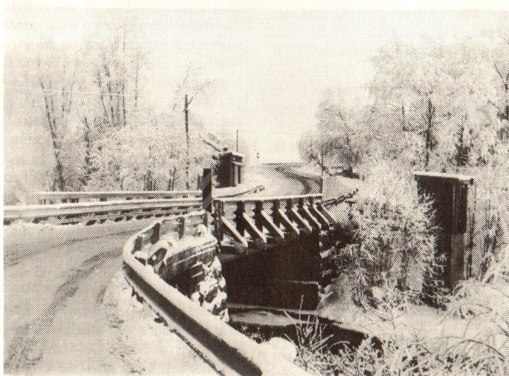
Kringlerdalen bru trenger å bli avløst av en mer tidsmessig og effektiv bru.
