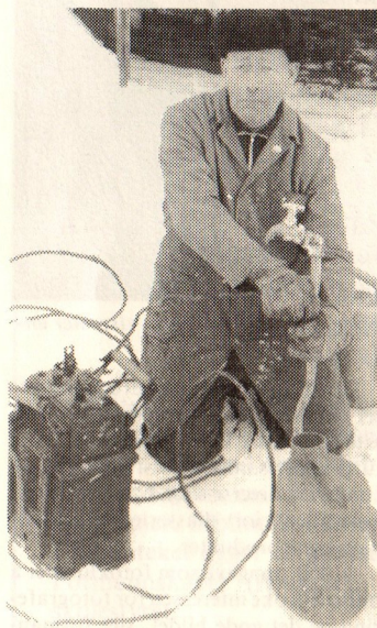
«Vanntiner» Hans Gunhildrud på plass med tungt utstyr for å bringe nytt liv i frosne vannrør.
