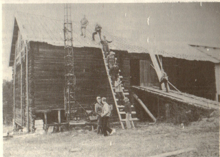
Fra leggingen av takstein på Sør-Kringler-låven. Her er det medlemmer av historielaget og Nannestad Rotary Klubb som sørger for at steinen kommer på plass.
