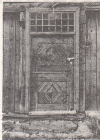
Inngangspartiet til hovedbygningen, der til og med dørhella er stjålet!
